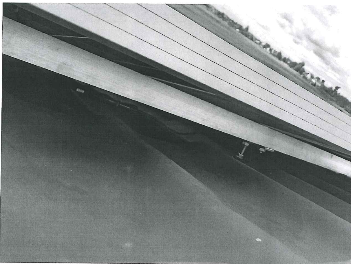
Przykładowa instalacja na dach skośny
