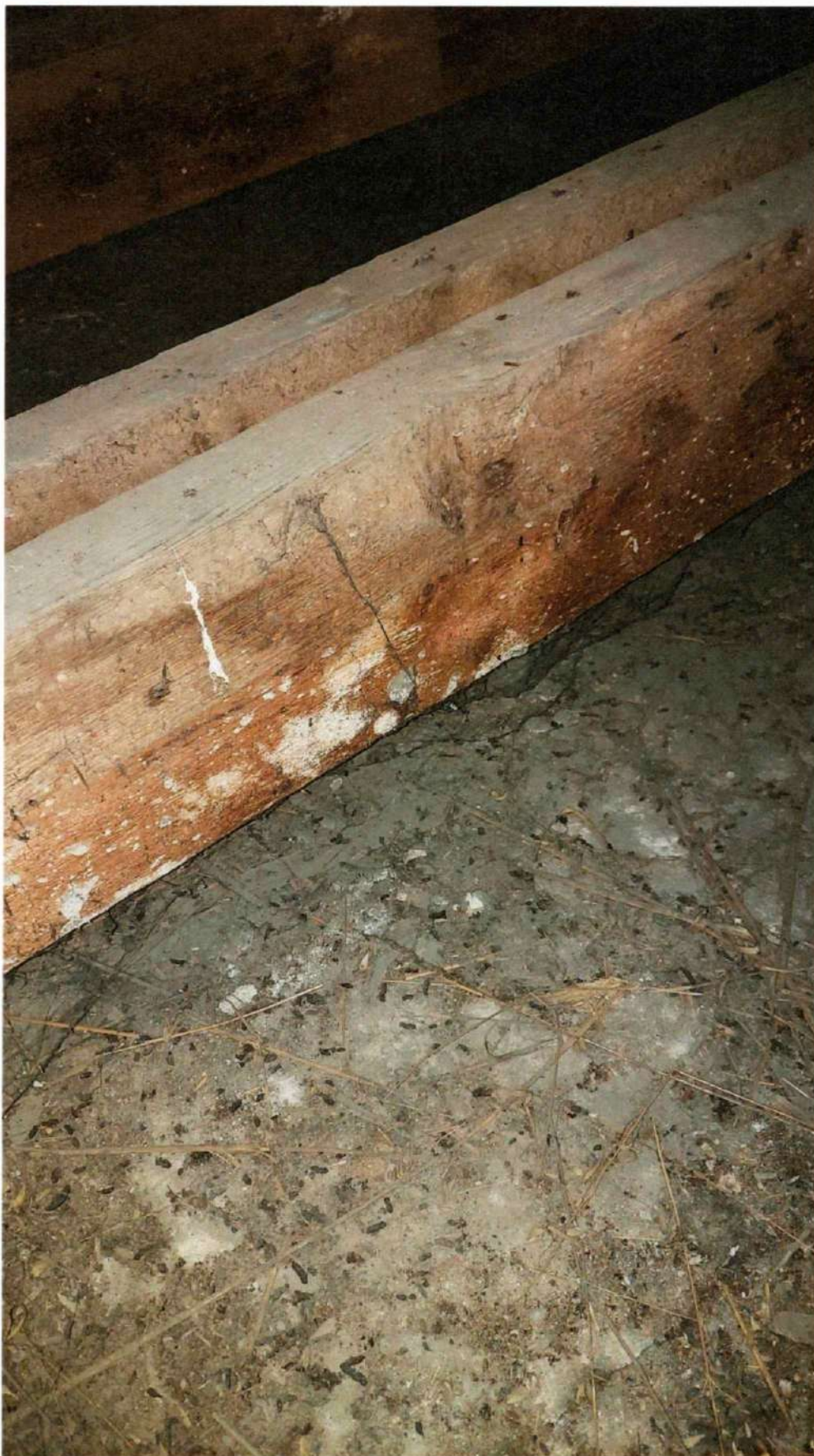
WIDOCZNA KOROZJA BIOLOGICZNA NA BELKACH STROPOWYCH
