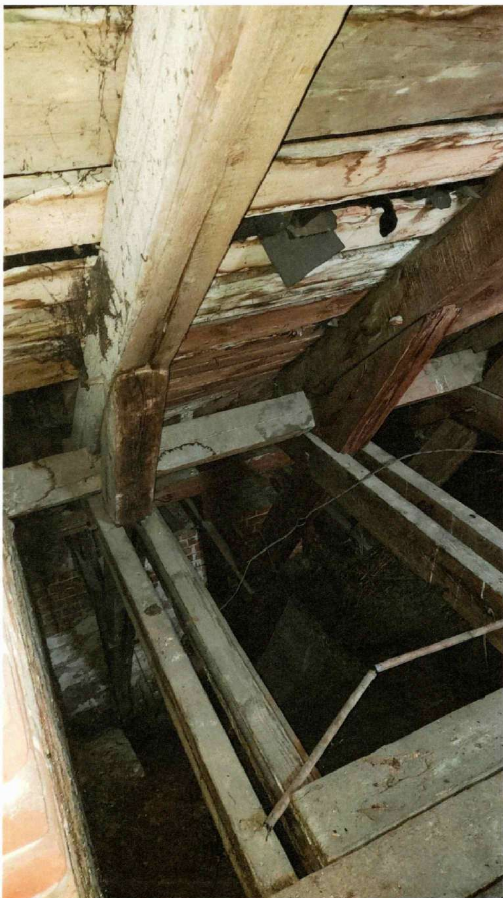
WIDOCZNE ZACIEKI NA DESKOWANIU POŁACI DACHU
