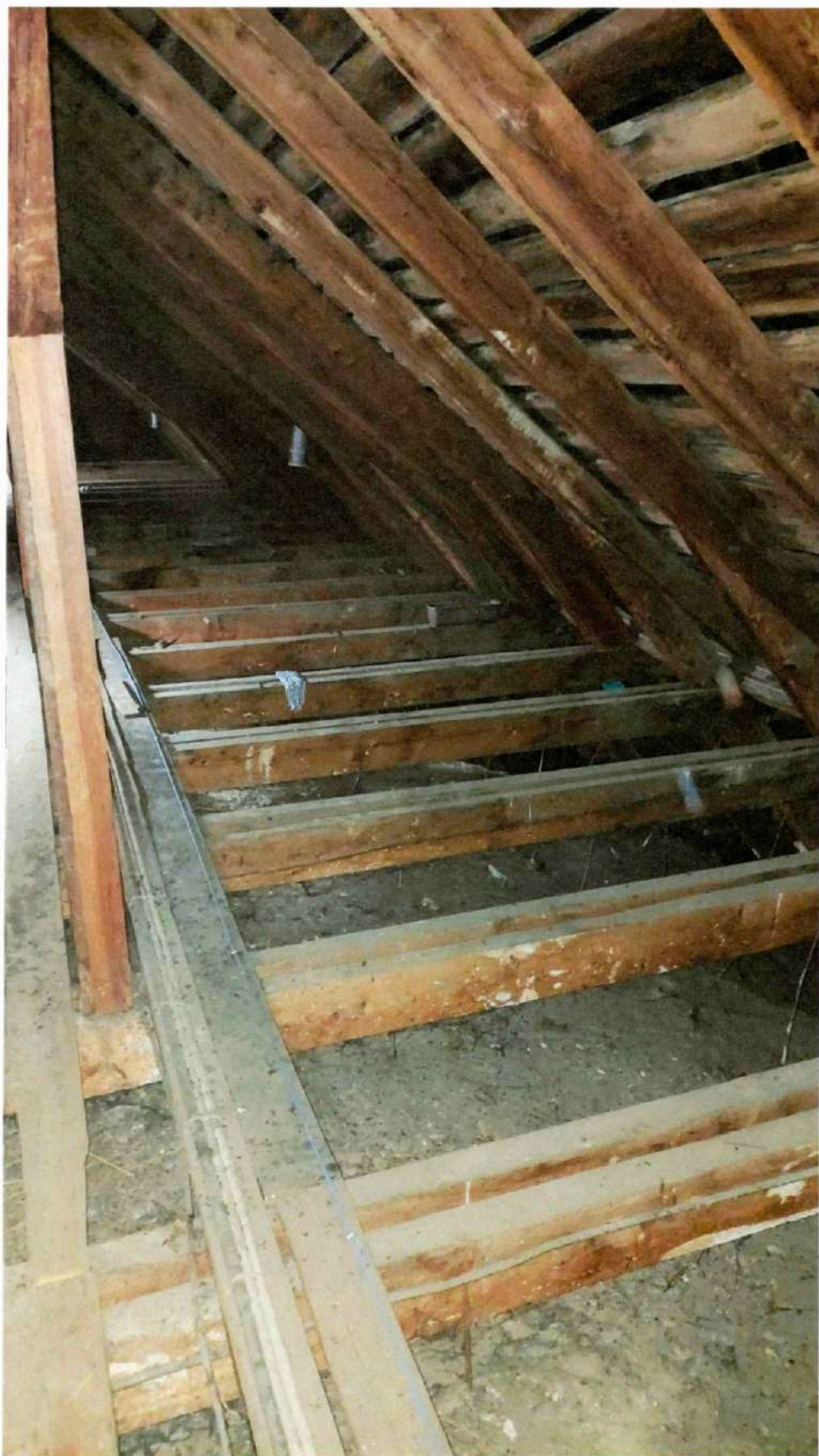
WIDOK BELEK STROPOWYCH ORAZ WIDOCZNA ICH KOROZJA
